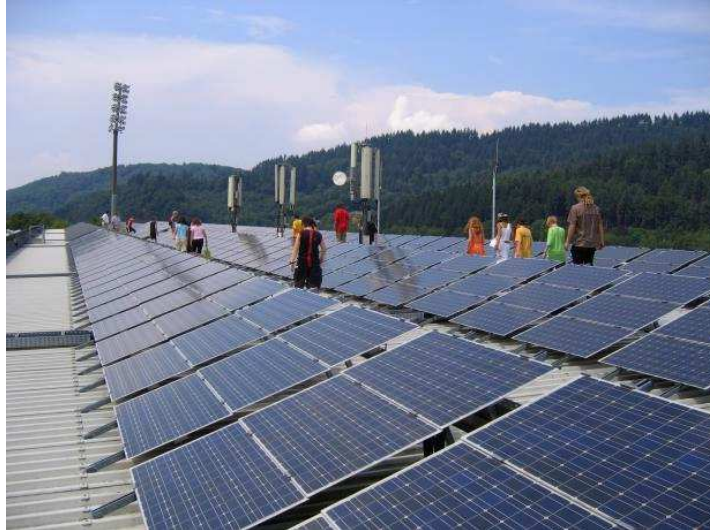
Auf dem Dach des Badenovastadions sind 805 m 2 Solarzellen installiert.
